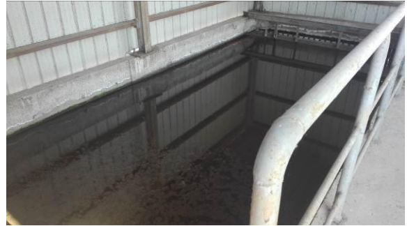
PE 微滤膜池
